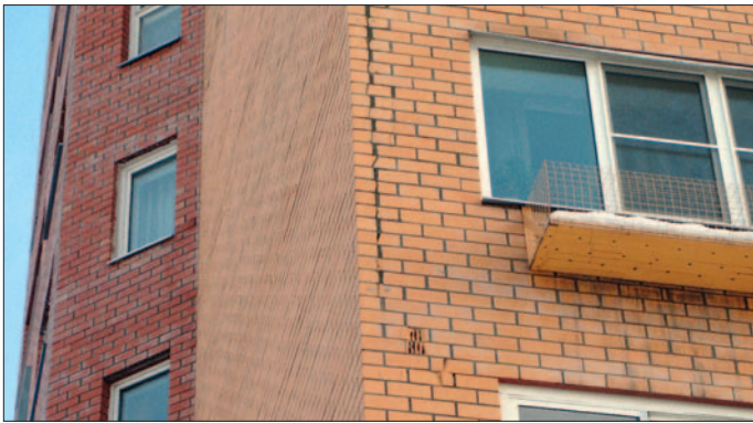
Фото 2. Вертикальные трещины в облицовке на углах здания
