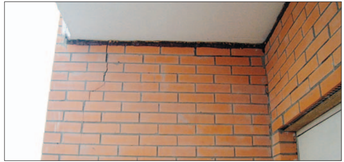
Фото 3. Трещины в кирпичной облицовке ограждения лоджий
